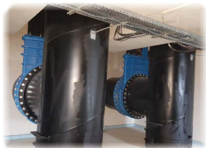
Серия 200 применение в системе водоочистки
